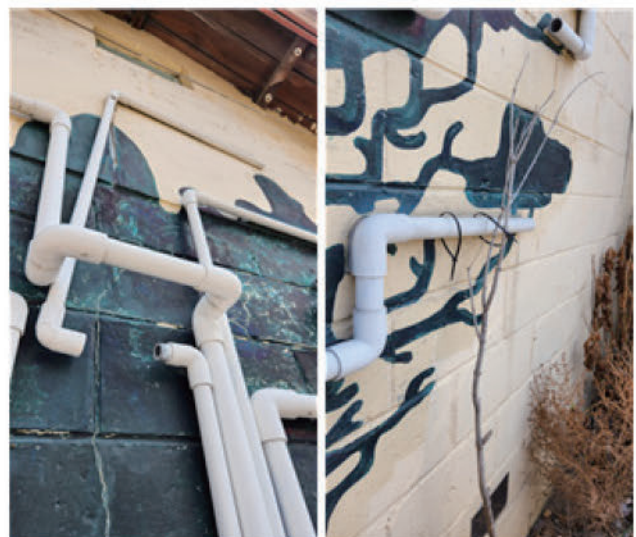
그림 11. 파손된 ‘벽 부조 2’(⑨) Figure 11. Damaged Wall Relief 2(⑨)
